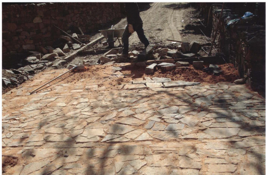
Requalificação do acesso ao poço em Cachopo: calçada irregular de xisto. (Gtaa Sotavento 2005)
